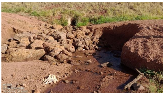
Figura 154. Saída do BSTC com aplicação de rachão e margem do curso d'água erodida.
