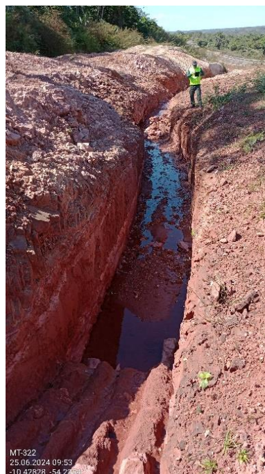
Figura 12. Afloramento de água em vala escavada.
