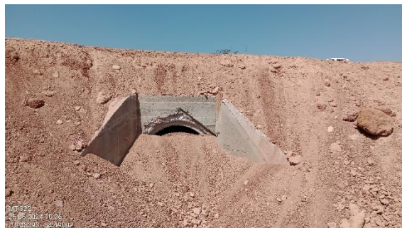
Figura 24. Acúmulo de sedimentos na entrada da OAC.
