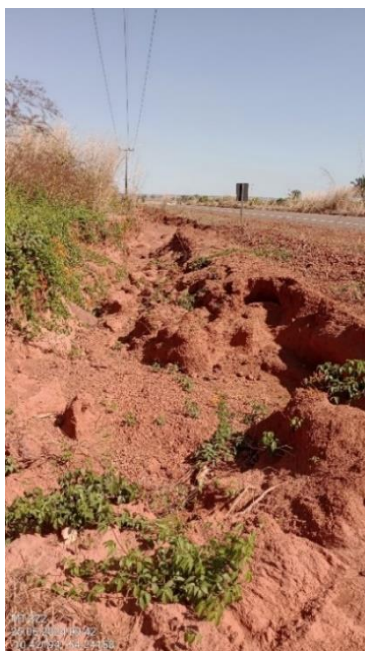
Figura 5. Processos erosivos próximos ao Km 635.
