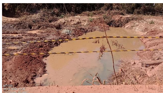
Figura 97. Curso hídrico assoreado e com elevada turbidez, próximo à frente de obra, a jusante.
