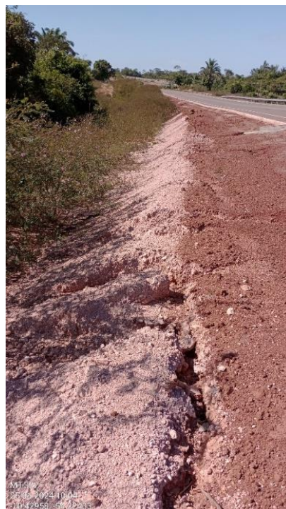
Figura 15. Formação de sulcos erosivos na margem da rodovia.
