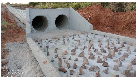
Figura 137. Dissipadores de energia.
