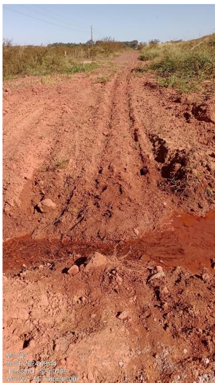
Figura 64. Marcas de passagem de veículos sobre o curso d'água, dentro da faixa de domínio, a jusante.
