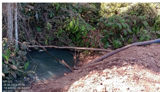
Figura 105. Captação superficial de água para abastecimento de caminhão-pipa.
