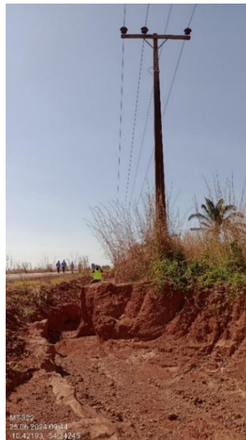
Figura 9. Processo erosivo próximo à linha de transmissão.
