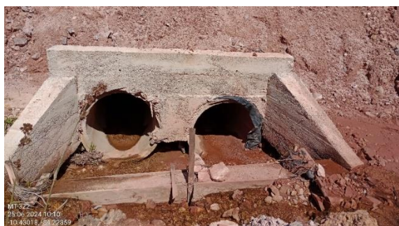
Figura 18. Estrutura do BDTC com avarias e acúmulo de sedimentos.
