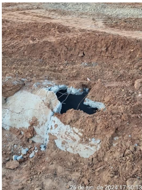
Figura 135. Estrutura da OAC danificada.
