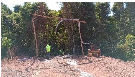
Figura 104. Captação superficial de água para abastecimento de caminhão-pipa.
