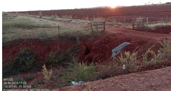
Figura 140. Formação de sulcos erosivos próximo a acesso a uma propriedade rural.
