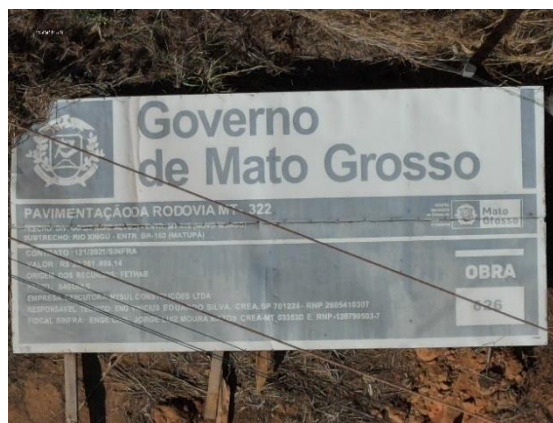
Figura 3. Foto aérea da placa caída, referente às obras de pavimentação da rodovia MT-322.
