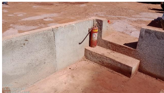
Figura 124. Entrada da caixa de contenção, onde foi tomada a medida da altura, e trincas na estrutura.
