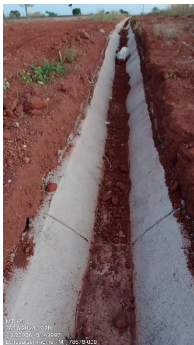
Figura 149. Canaleta com acúmulo de sedimentos.
