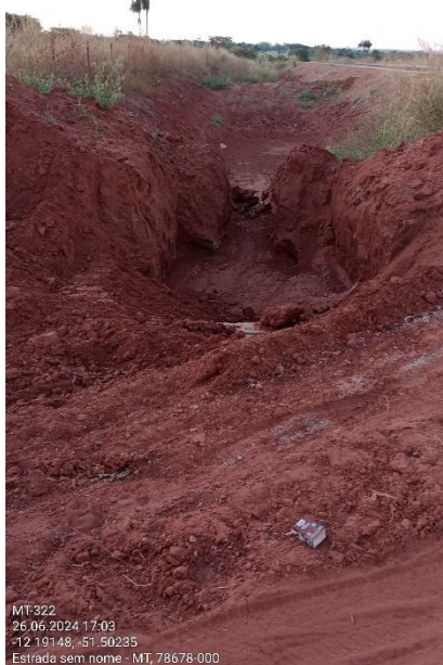
Figura 139. Erosão na margem da rodovia.
