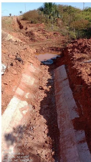
Figura 51. Canaleta de drenagem com acúmulo de sedimentos.
