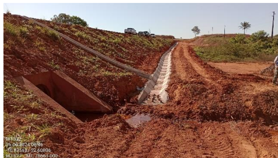
Figura 63. Sistema de drenagem próximo a corpo hídrico degradado, com marcas de passagem de veículos.
