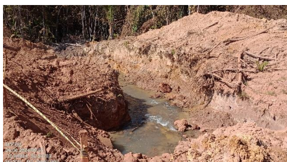
Figura 102. Curso d'água com as margens aterradas e restos vegetais, a jusante da rodovia.
