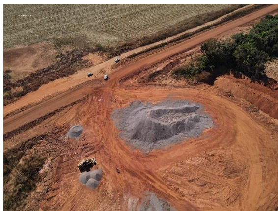
Figura 111. Depósito de britas.
