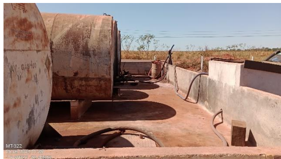
Figura 128. Interior da caixa de contenção.
