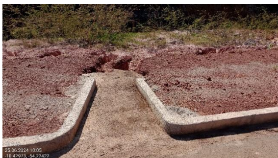
Figura 14. Erosão abaixo de dispositivos de drenagem com avarias.
