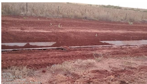
Figura 147. Canaleta com acúmulo de sedimentos.
