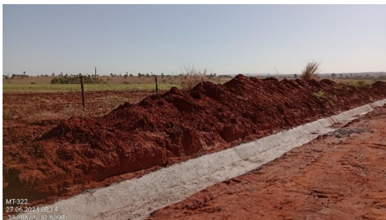
Figura 150. Disposição de sedimentos próximo à canaleta.
