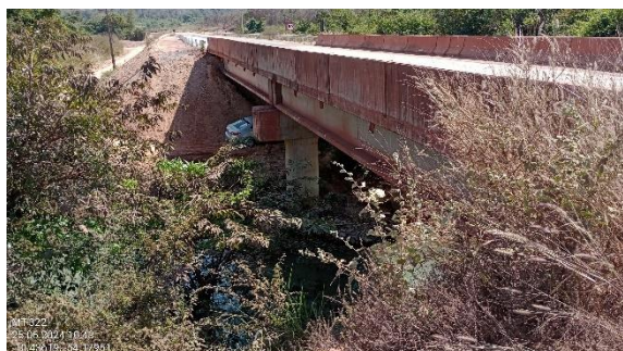
Figura 27. Talude do encabeçamento da Ponte sem proteção vegetal.
