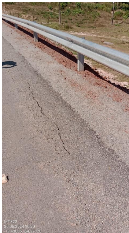
Figura 21. Rachadura no asfalto próximo a talude de aterro.
