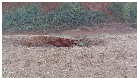
Figura 141. Formação de sulcos erosivos em corpo de talude.
