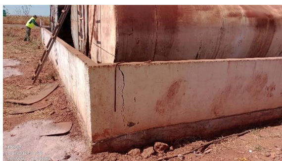
Figura 125. Trincas na estrutura da caixa de contenção.
