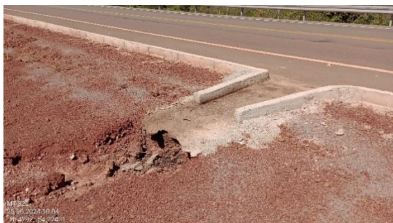
Figura 13. Erosão abaixo de dispositivos de drenagem com avarias.
