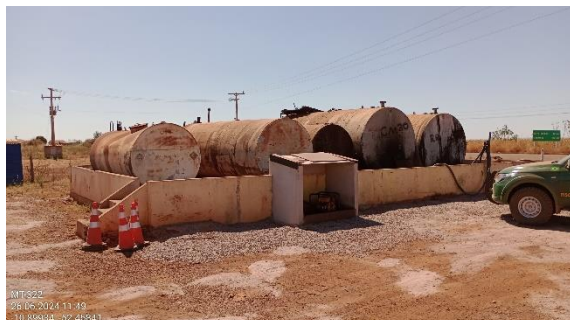
Figura 123. Caixa de contenção de tanques de armazenamento.
