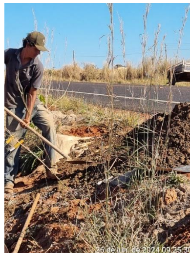
Figura 67. Trabalhador em frente de obra sem EPI.
