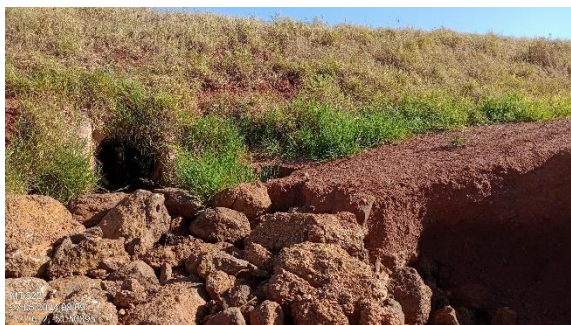
Figura 155. Detalhe da saída do BSTC.
