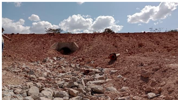
Figura 23. Acúmulo de sedimentos na saída do BSTC e aplicação de rachão a jusante.
