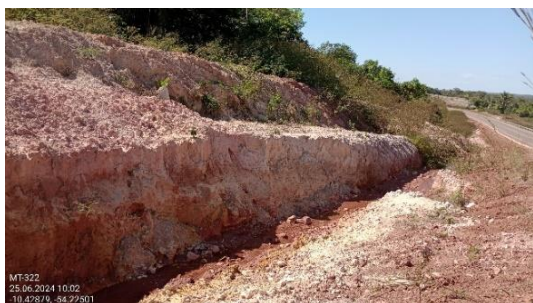
Figura 11. Talude de corte sem vegetação.
