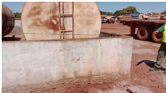
Figura 127. Trincas na estrutura da caixa de contenção.
