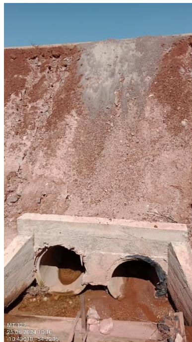
Figura 19. Talude sem vegetação acima do BSTC.
