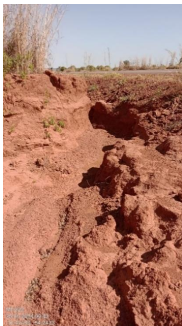
Figura 6. Processos erosivos próximos ao Km 635.
