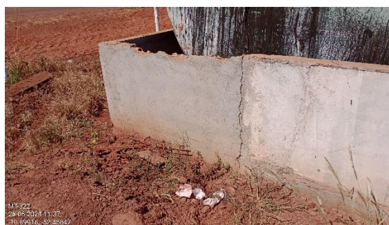
Figura 126. Trincas na estrutura da caixa de contenção.
