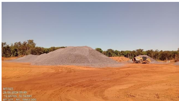
Figura 112. Depósito de britas.
