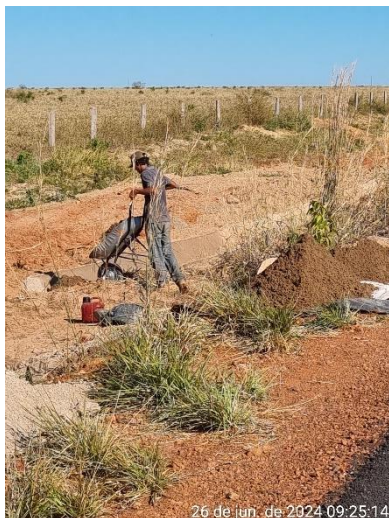
Figura 66. Trabalhador em frente de obra sem EPI.
