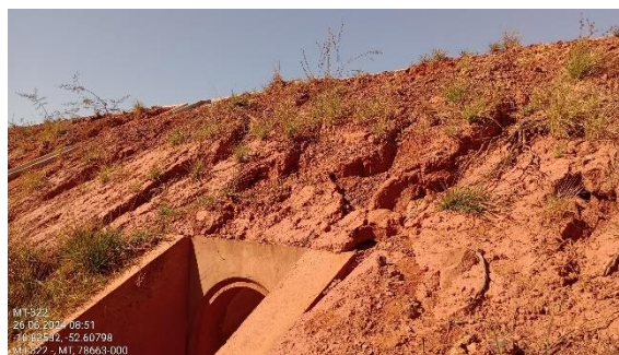
Figura 59. Formação de sulcos erosivos no corpo do talude, acima de BSTC.
