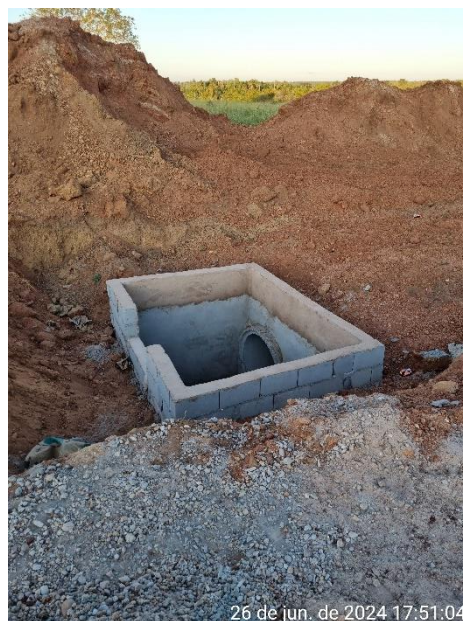
Figura 136. Caixa de inspeção.
