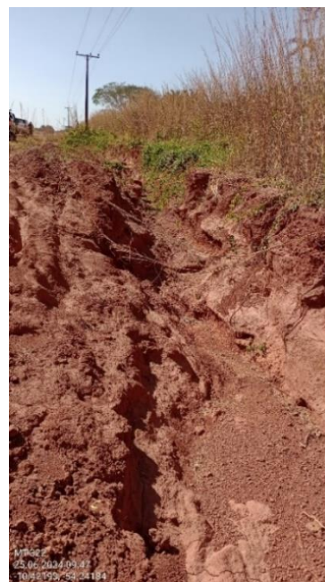
Figura 7. Processos erosivos próximos ao Km 635.
