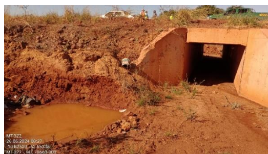
Figura 52. Acúmulo de água ao final da canaleta e disposição irregular de resíduos sólidos próximo ao BSCC.
