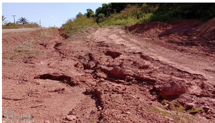
Figura 16. Formação de sulcos erosivos na margem da rodovia.
