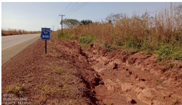
Figura 4. Processos erosivos na margem da rodovia no Km 635.
