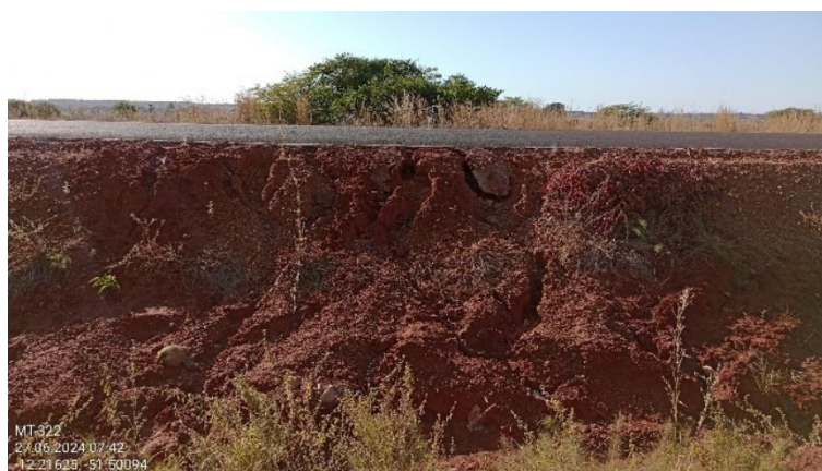
Figura 142. Formação de sulcos erosivos em corpo de talude, próximo ao lixão.
