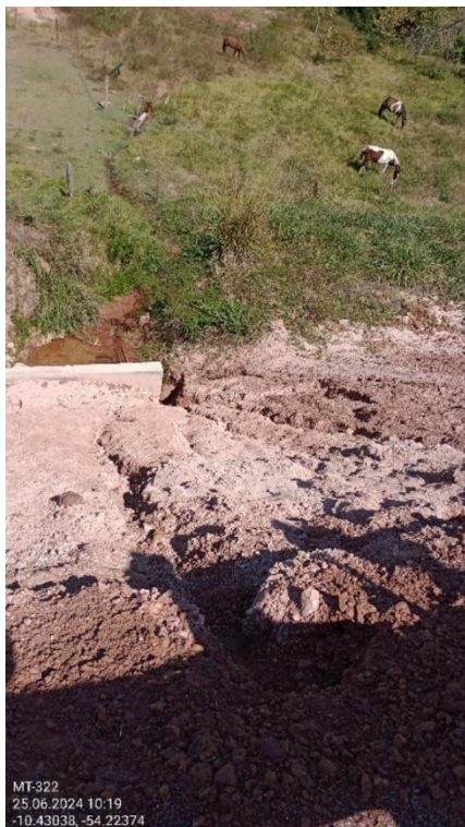
Figura 20. Formação de sulcos erosivos no corpo de talude sem proteção vegetal.
