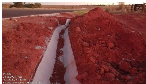
Figura 148. Canaleta com acúmulo de sedimentos.
