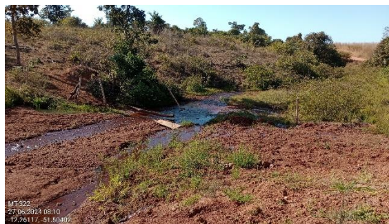
Figura 153. Curso hídrico com acúmulo de sedimento e sem APP, a jusante da rodovia.
