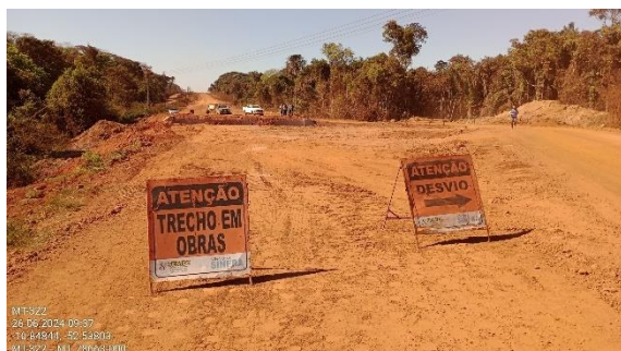
Figura 98. Placas instaladas no trecho em obras.
