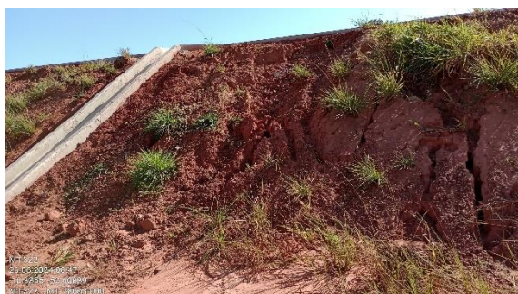
Figura 60. Formação de sulcos erosivos no corpo do talude.
