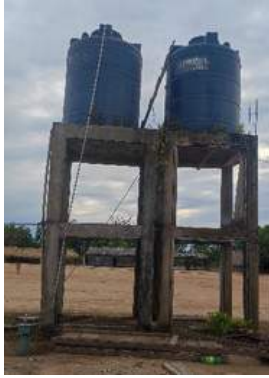
FIGURA 117 POÇO ARTESIANO E CAIXAS D'ÁGUA, ALDEIA KAMAU, EM 05/10/2023.
