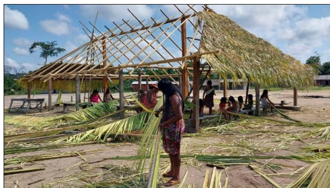
FIGURA 48 RENOVAÇÃO DO TELHADO DA CASA DO GUERREIRO, ALDEIA KAMAU, NOVEMBRO DE 2022 (ACERVO SERABI NA VERSÃO PRIMÁRIA DO ESTUDO PELA EQUIPE ANTERIOR).
